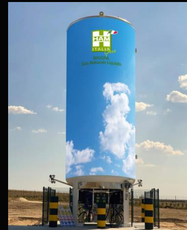
Impianti rimovibili Benito GNL
