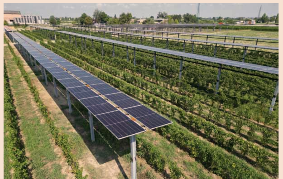
Nuovo impianto Agrivoltaico avanzato sul vigneto adiacente a Cantine Caviro
